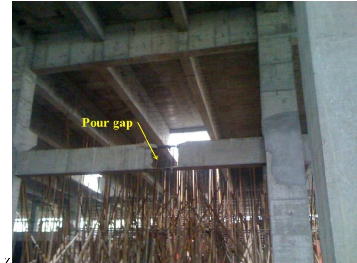
Fig. 1 A pour gap in a concrete beam
